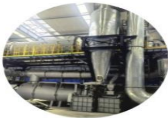
脱漆生产线 Decoating Line
